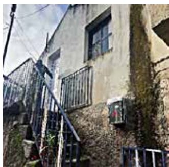
Figura 1 - Habitação degradada e com barreiras arquitetónicas
